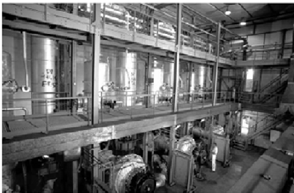
Diffuseurs en exploitation (1996)
